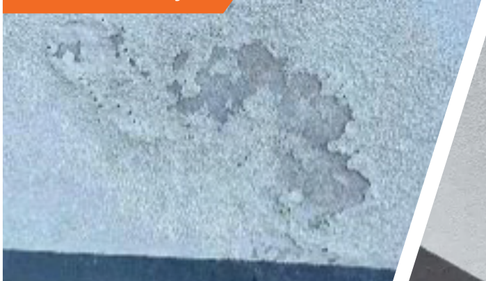
Stucwerk na 7 jaar
